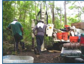
SWMU 61 – Los excavadores de JFA están instalando un pozo de monitoreo de agua subterránea
